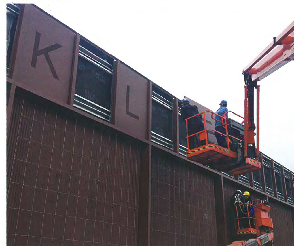
Op de gevel is de aanduiding Kolleksjesintrum Fryslân geplaatst met geperforeerde letters in aluminium cassettes.
